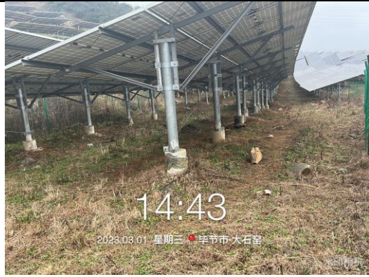
地块3光伏阵列植被恢复情况
