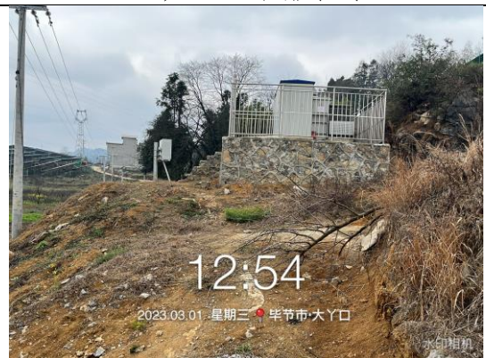
地块2 箱变周围植被恢复情况
