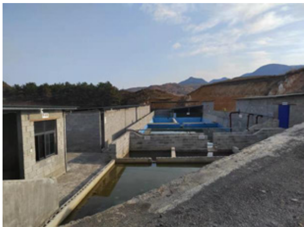
污水处理设施（沉淀池、过滤池、事故池）
