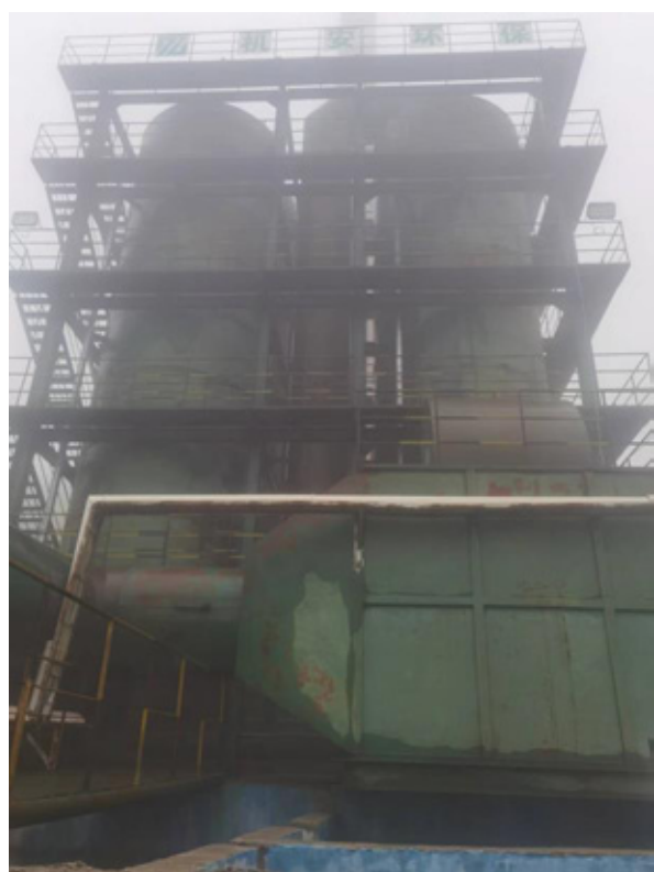
二期验收熔化炉与一期熔化炉共用 60m 高 排气筒
