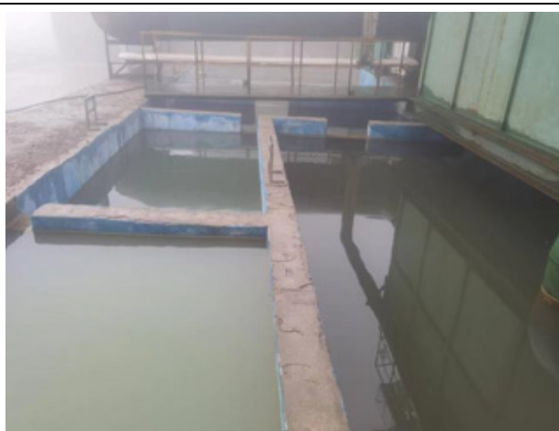
二期验收熔化炉与一期熔化炉共用钠碱法 脱硫技术装置
